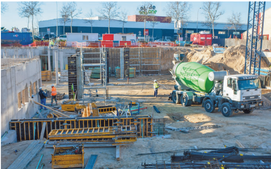
Estado actual de los trabajos en el entorno de glorieta de Virgen de las Angustias
