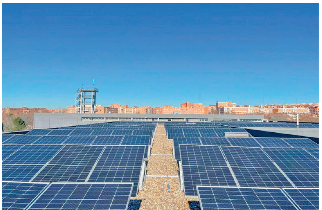
Placas solares en una cubierta de Alcorcón AYUNTAMIENTO DE ALCORCÓN
