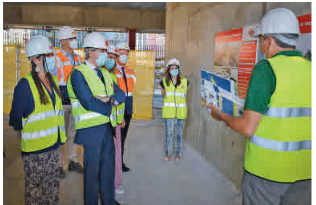
Garrido realizó el anuncio durante una visita a las obras de la futura sede de Metro
