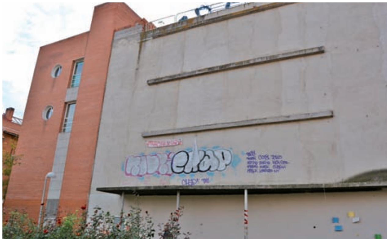
Estado actual del edificio abandonado, frente la plaza de los Evangelios PEPE RIOFRÍO / GENTE
