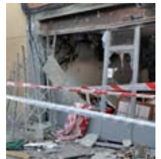
Imagen de los daños
