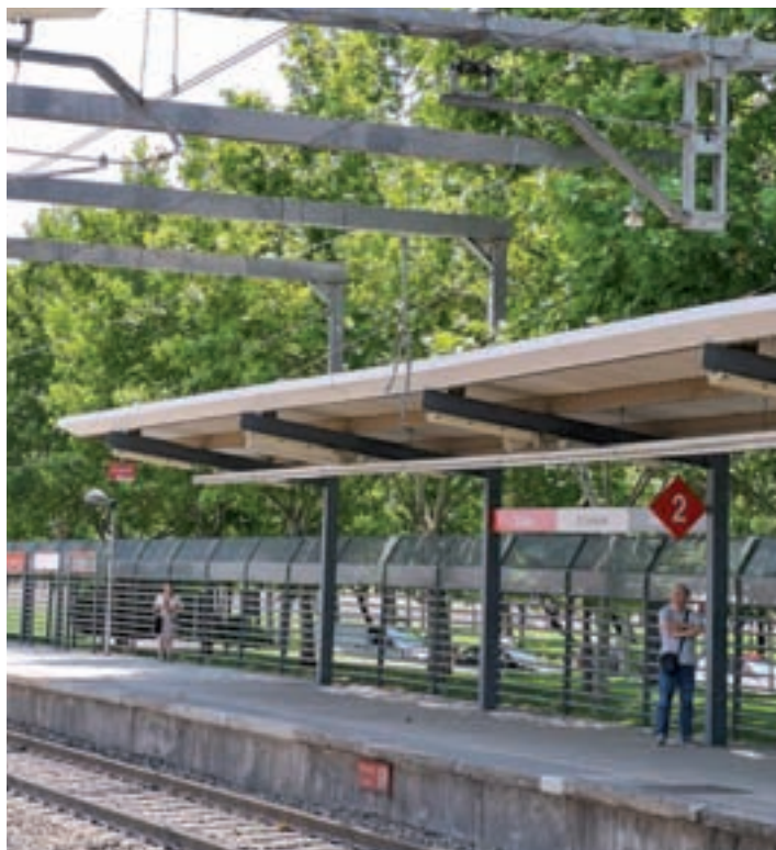
Catenaria rota en El Casar
