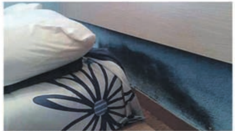
Problemas de humedad por capilaridad
