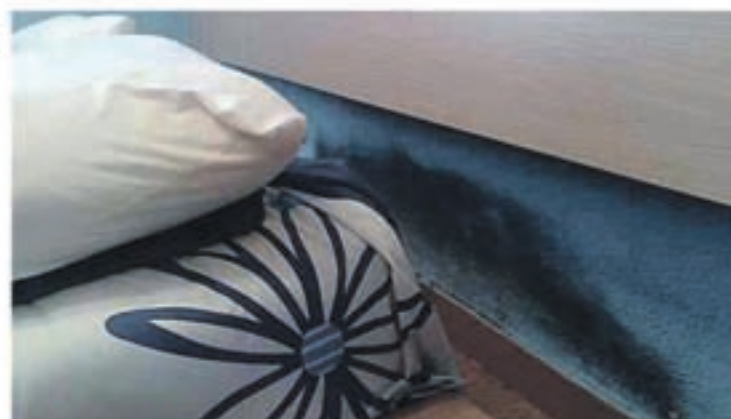
Problemas de humedad por capilaridad
