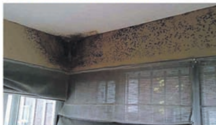
Problemas de humedad por condensación
