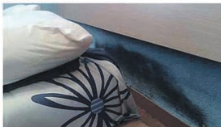
Problemas de humedad por capilaridad
