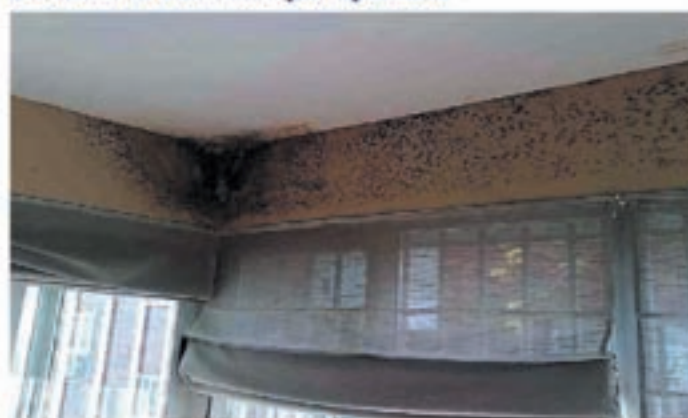
Problemas de humedades por condensación
