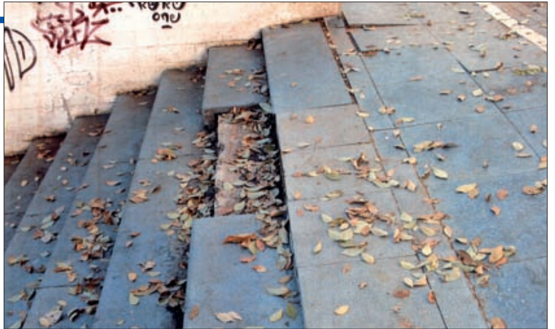
Estado de una de las escaleras del barrio del distrito de Latina
