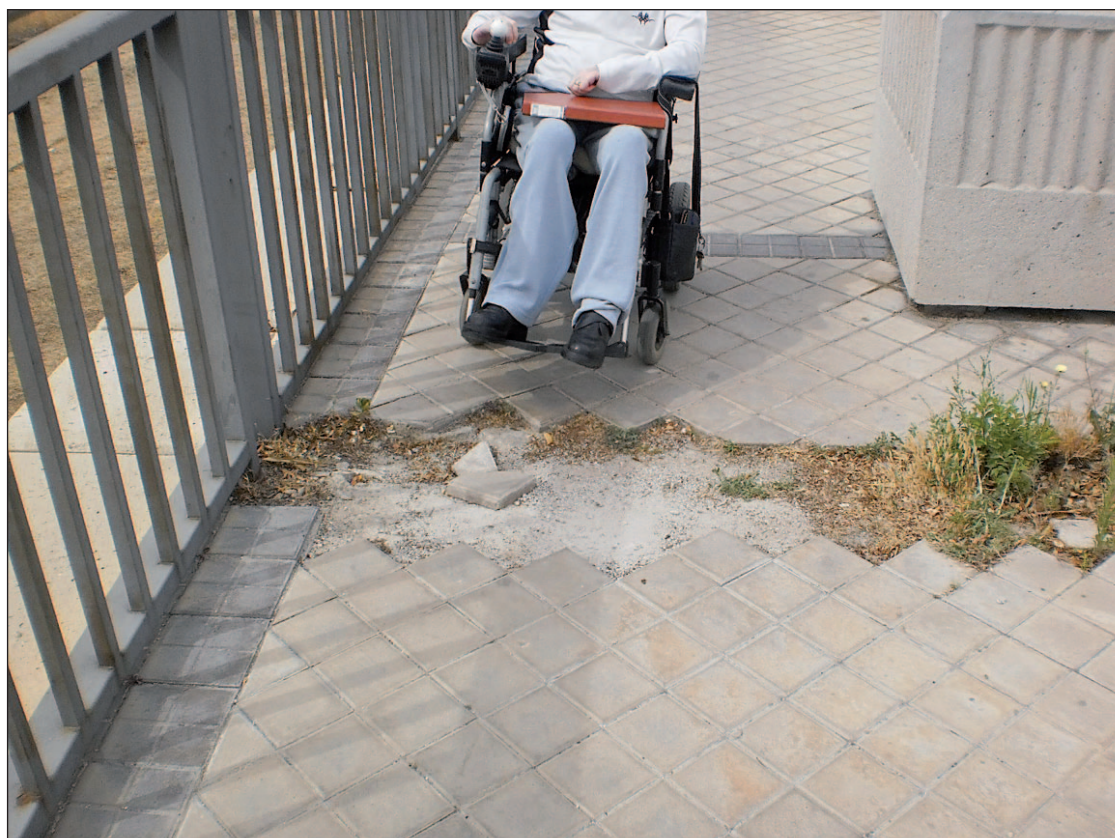
Uno de los múltiples obstáculos existentes en la Gran Vía de Villaverde
