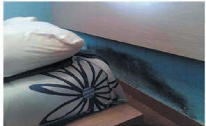
Problemas de humedades por capilaridad
