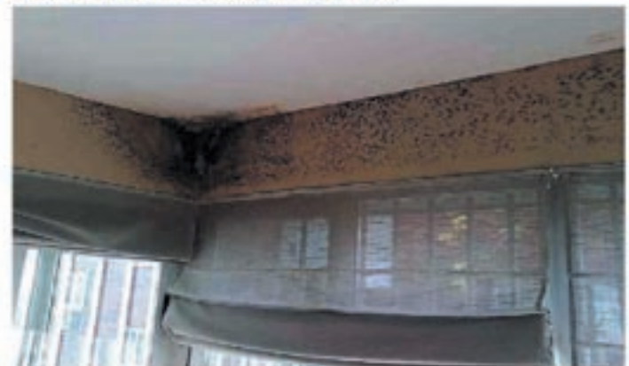
Problemas de humedades por condensación
