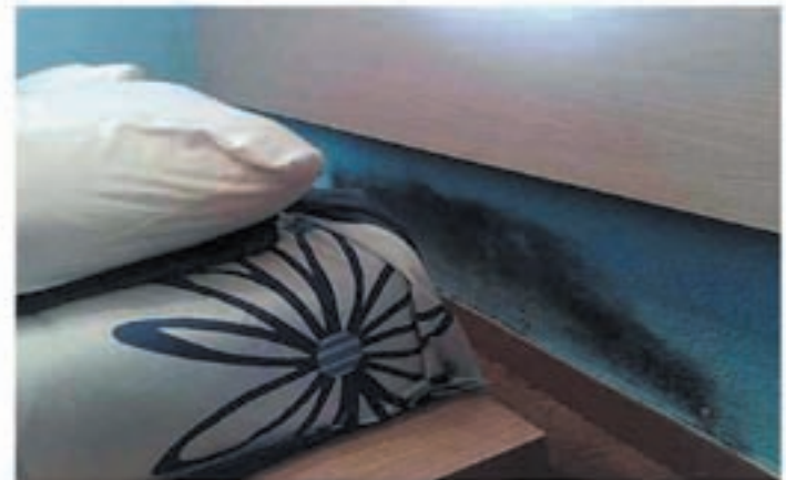
Problemas de humedades por capilaridad
