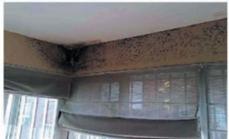
Problemas de humedades por condensación
