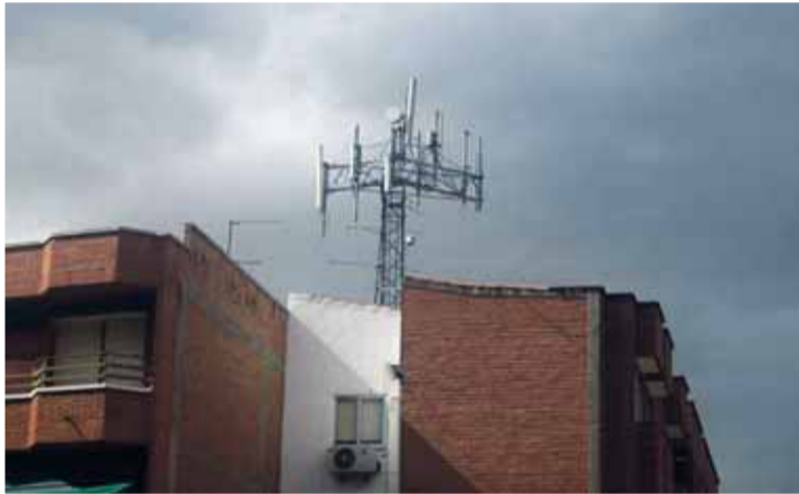
Una de las antenas de telefonía instaladas en un edificio.
