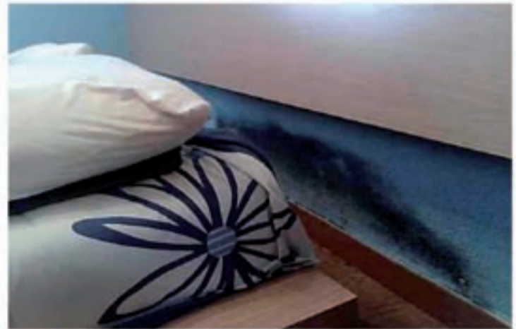
Problemas de humedades por capilaridad
