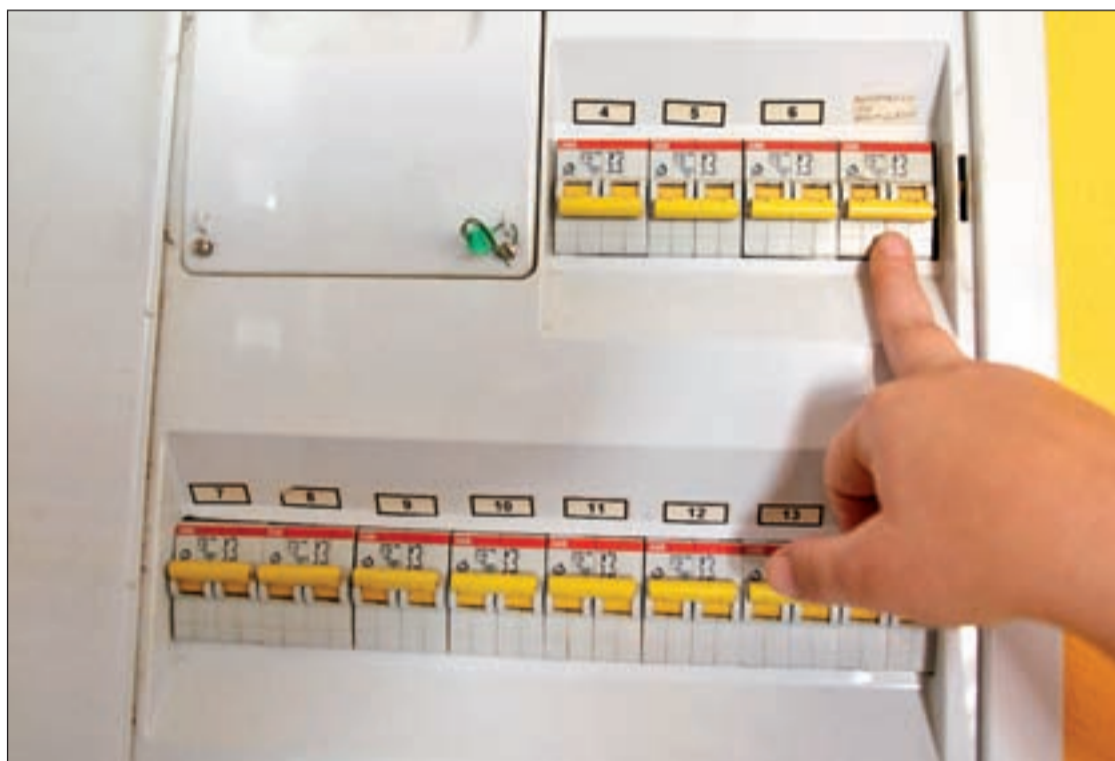
Los vecinos muestran que bajan los interruptores del cuadro para no gastar MANUEL VADILLO/GENTE
