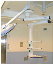
Quirófano del Centro de Especialidades de Arenas de San Pedro.
