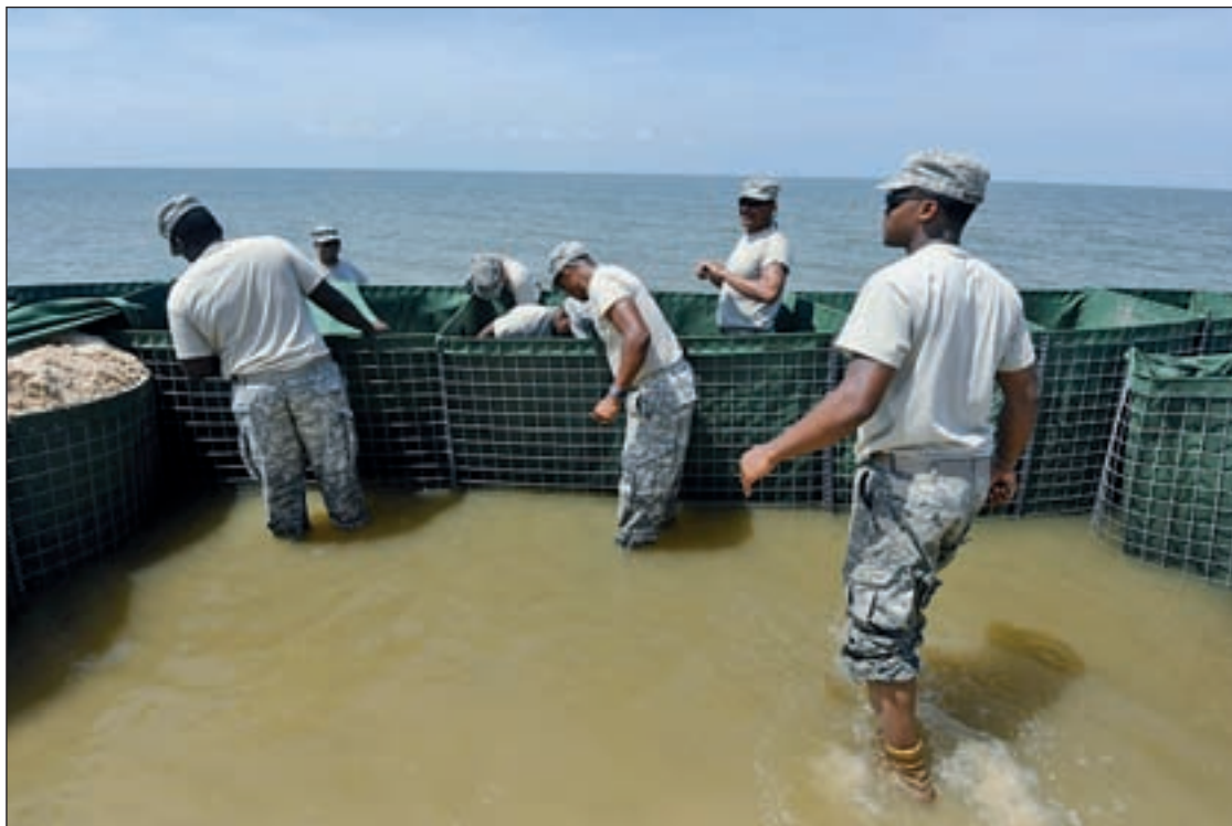
Operarios de Alabama levantan muros de contención para evitar que la fuga llegue a su costa
