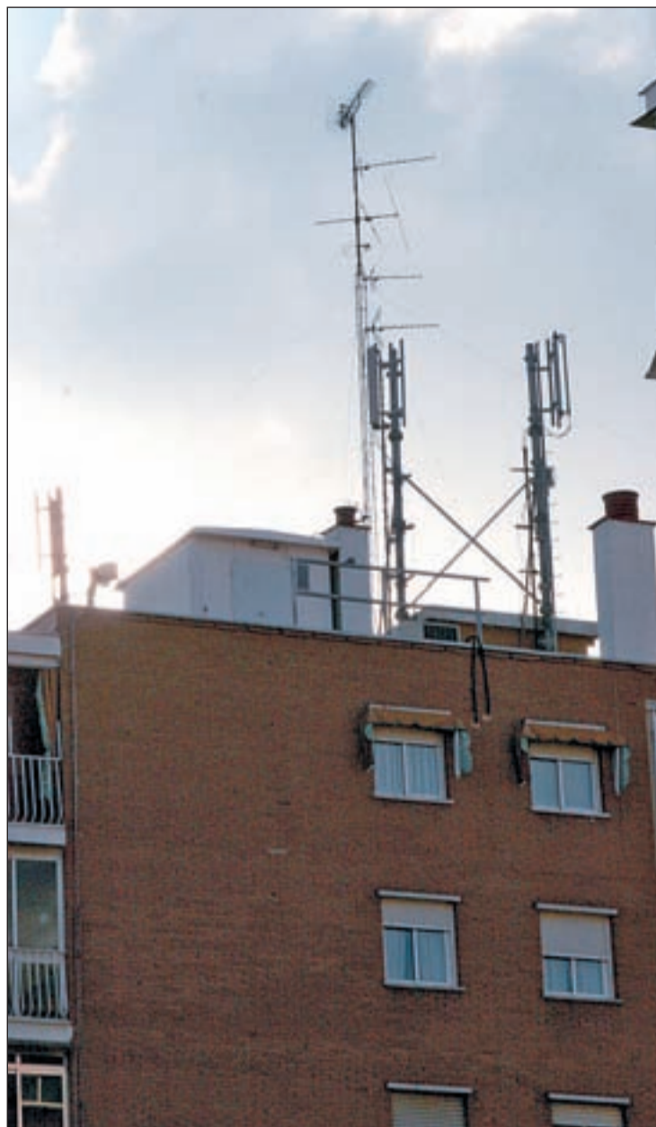
Una antena en la azotea de un edificio MANUEL VADILLO/GENTE
