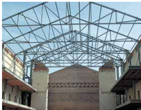
El Ayuntamiento deberá rebajar las cerchas 4,43 metros.
